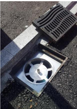
Kuva 4: ENREGIS / Vivo ® CRCsorp asennettuna hulevesikaivoon
